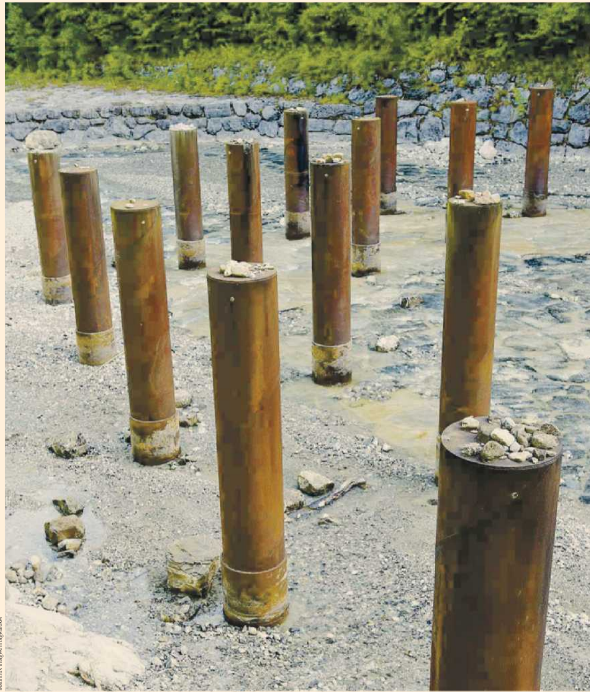
Nicht schön, aber effektiv: Stahlsäulen fangen im Lainbachtal bei Benediktbeuern mitgerissene Baumstämme auf, damit sie sich nicht an Brückenpfeilern verfangen und die Brücken in Gefahr bringen
